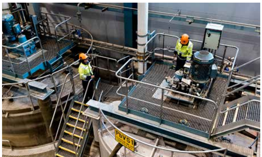
Bolidenin Kokkolan tehtaan hopean talteenotossa otettiin käyttöön ABB Ability 800xA -automaatiojärjestelmä.
