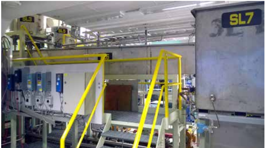
Vesiprosessin ohjaukseen voi valita ABB500- ja Simatic S7 -logiikoita tai ABB800- tai Metso-automaatiojärjestelmiä.
