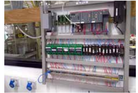
Osaprosessin ohjaukseen tarkoitettu ABB500-logiikan ohjaustaulu automaatiovalvomossa.
