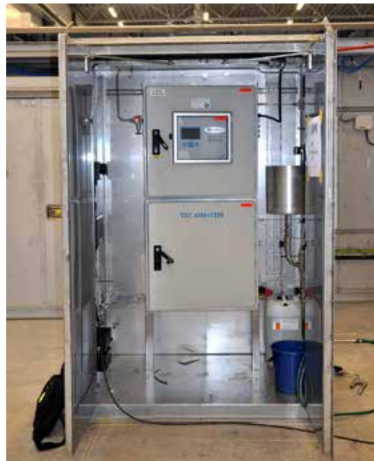
Hach Biotector B7000 TOC-analysaattori omassa suojakopissaan sellutehtaan jätevesiä mittaamassa.
