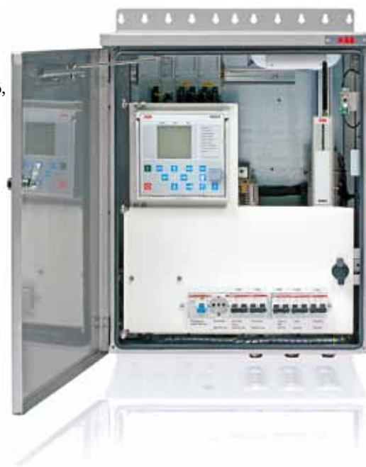
Kauko-ohjattavien muuntajien automaatiokaappeihin on asennettu ohjaus- ja valvontayksikkö sekä langaton reititin.
