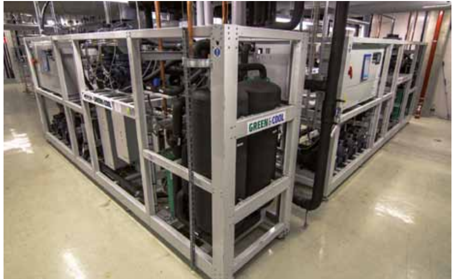
Kolme kylmäkonepakettia on kytketty osaksi kauppakeskuksen talotekniikkaa.
