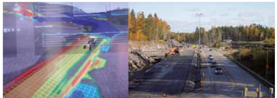
Topconin Site Link 3D -järjestelmä (vasen) väylärakennustyömaan (oikea) dynaamiseen johtamiseen (esimerkkikuvat eivät liity toisiinsa).
