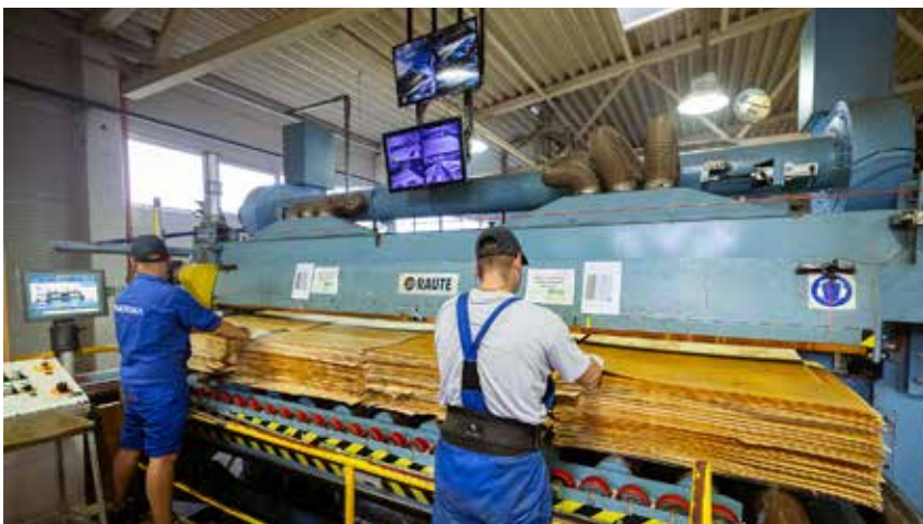
Viilun kuivauskoneen puhdistusaika on lyhentynyt noin puoleen tekoälymoduulin ansiosta. Kuvassa viilun kuivauslinjan syöttölaite.
