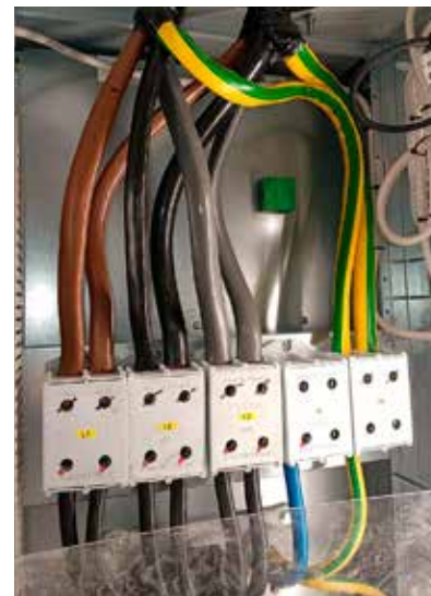
Thermal Tageja (kuvassa vihreä laatikko) voi asentaa kiskoston kylkeen. Sensorit yhdistyvät langattomasti reitittimeen, ja ohjelmiston avulla käyttäjät pääsevät katsomaan sensoreiden mittauksia.
